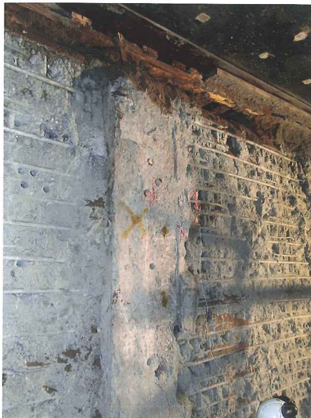
5 Situatie vóór ontsteking, na verwijderen betondekking
